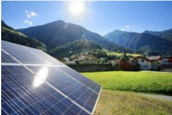
Abb. 11: PV-Anlage in Mörttschach, © B. Krobath
