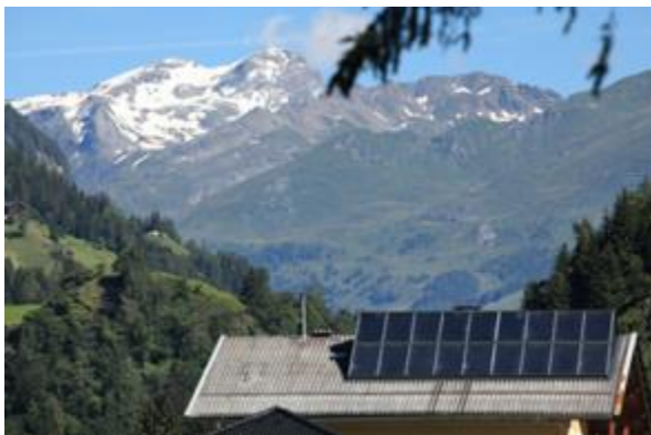
Abb. 47: Private Solaranlage in Großkirchheim, © B. Krobath
