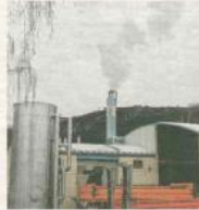
Das Biomasse-Heizwerk liefert seit über 30 Jahren nachhaltige Energie.
