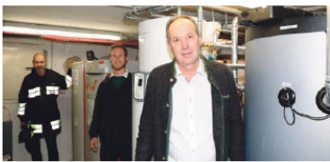
Kommandant Georg Rumppler, Jakob Fröhling und Bürgermeister Franz Rumppler bei der neuen Heizung im Feuerwehrhaus St. Veit.
