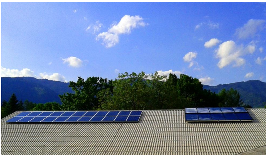
Abbildung 20: Photovoltaik und Solarthermieanlage HS Dr. Theodor-Körner
